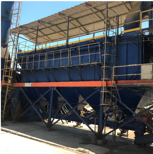
Fotografía 7. Sistema de control de emisiones – Filtro de mangas
