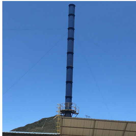
Fotografía Chimenea, plataforma y puertos de muestreo.
