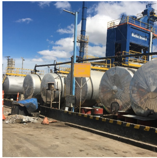
Fotografía 4. Tanques de almacenamiento de asfalto.
