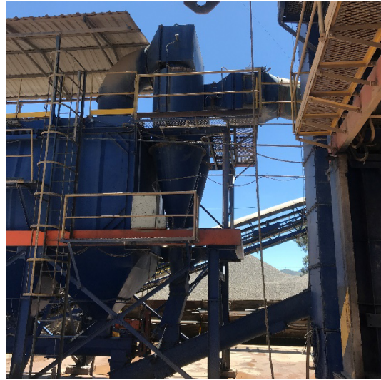
Fotografía Sistema de control de emisiones – Dos (2) ciclones.
